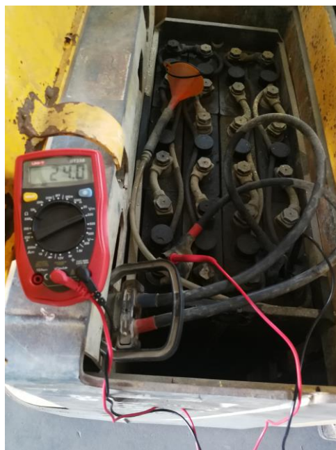
Slika 7.2. Baterija električnog viličara i izmjereni napon na voltmetru
